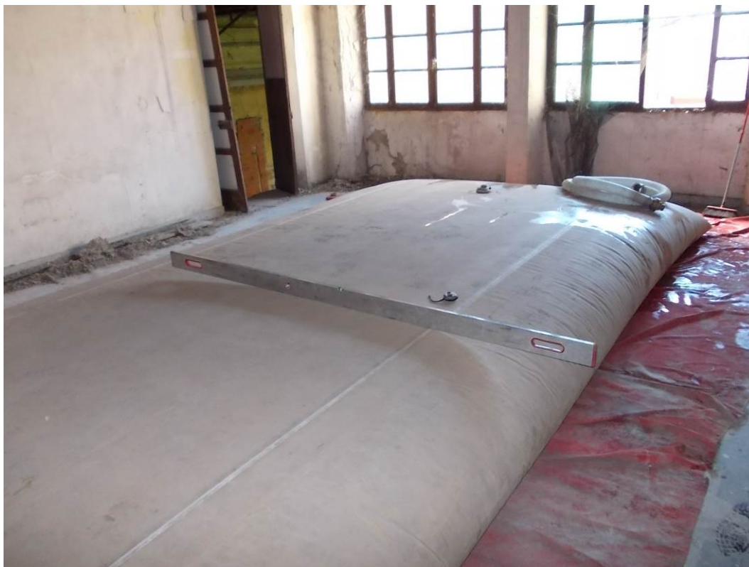
Serbatoio al carico di collaudo.
