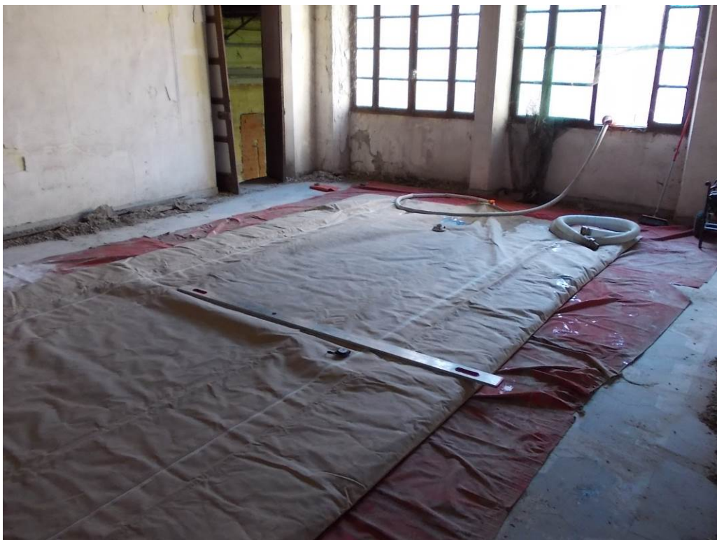
Particolare di un serbatoio in fase di riempimento.
