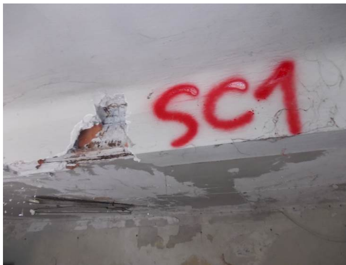
SCS1 – rompitratta metallica.
